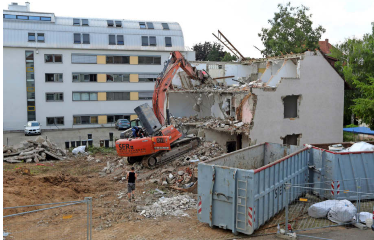
Das leerstehende Wohnhaus gegenüber der Hoerner-Bank-Zentrale wird derzeit abgerissen. An der Ecke Bismarckstraße/Oststraße entsteht in den nächsten Monaten für rund drei Millionen Euro ein Neubau.
